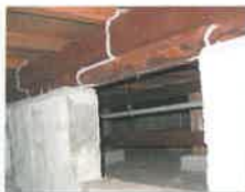
蟻道 土の中から土台そして柱に 蟻道を作り侵入してきます。
