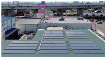
店舗屋上などへの自家消費型太陽光発電設備の導入（写真は愛知県一宮市のPRO一宮店）
